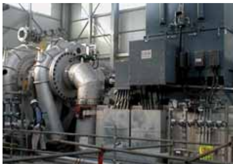
12 MW Motor / Generator Asynchron-Schleifringläufer mit Bürstenabhebevorrichtung
